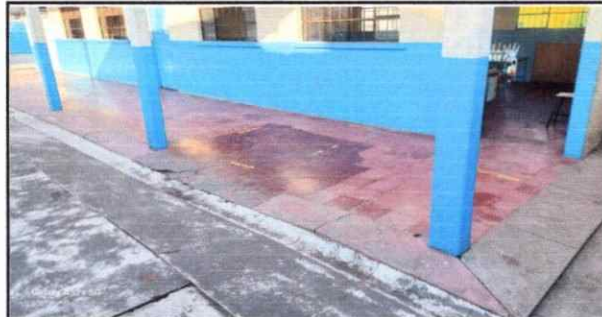
Foto 6: Se observa el deterioro del piso en patio.
