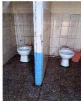
Foto 10: Se observan inodoros incompletos, en área de niños.
