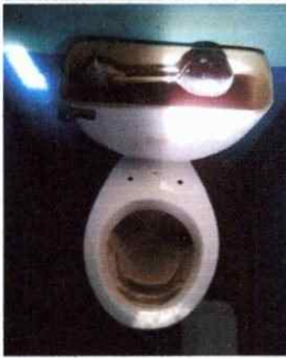
Foto 9: Se observa el deterioro del inodoro, área de docentes.
