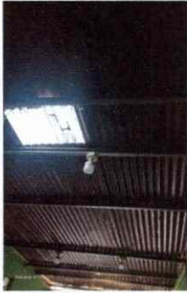
Foto 1: Se observa el deterioro en las láminas de la cocina.
