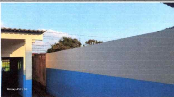
Foto 3: Se observa la necesidad de techar para pasar a la cocina
