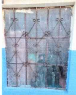
Foto 5: Se observa la ventana de cocina sin ninguna ventilación.
