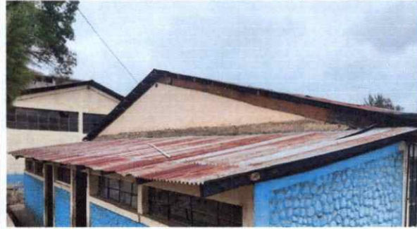
Foto 2: Se observa el deterioro de las láminas y vigas de madera en baños de docentes.
