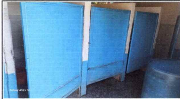
Foto 4: Se observa el deterioro de las puertas de los baños.
