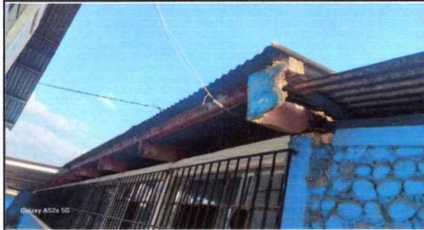
Foto 7: Se observa la falta de canal y bajada de agua pluvial
