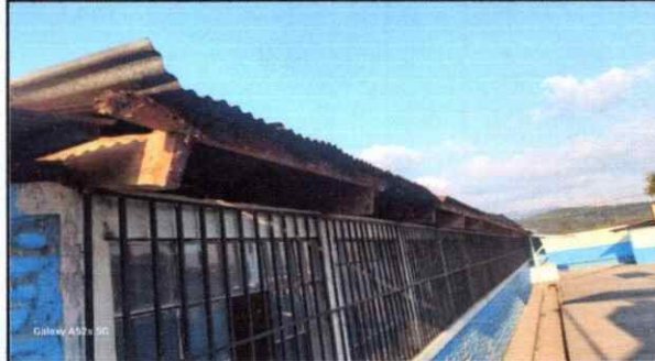
Foto 8: Se observa viga de madera en deterioro.
